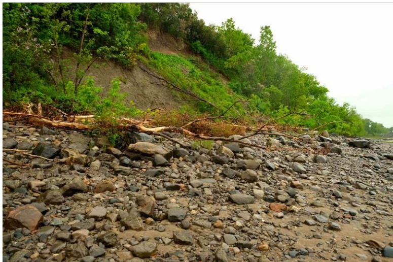
Étant donné la composition des sols, le pied du talus est érodé par les conditions hydriques du fleuve. De plus, une rupture sur le plan circulaire peut se produire sur une grande partie du talus. La possibilité de l'instabilité géotechnique et d'un glissement important rend nécessaire la réalisation d'une étude géotechnique pour déterminer la stabilité du talus et la possibilité d'intervention.
