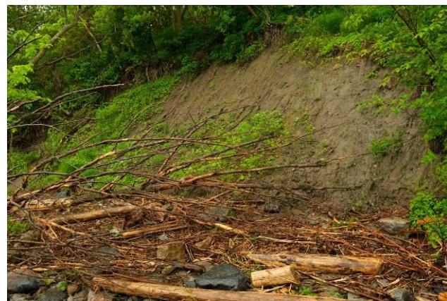
La majeure partie de la pente est dans un état de stabilité précaire.
