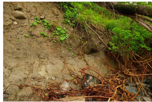
Érosion active du talus argileux.
